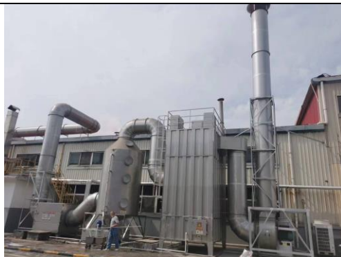
废气治理设施
